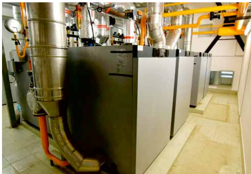
Plynové kotle, foto © TZB-info
