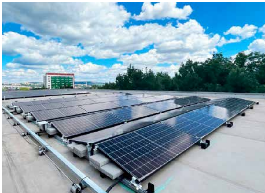
Fotovoltaika na střeše SOLSOL, zdroj SOLSOL
