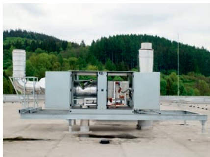
Instalace Heat Recovery Systému ve vnějším prostředí – Slovensko
