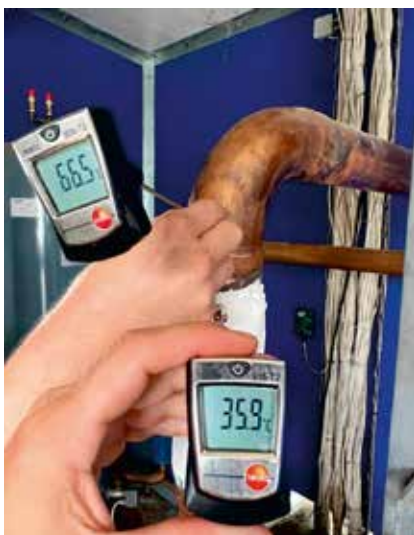
Obr. 4 Měděné potrubí bez nátěru a část s nátěrem tl. 2 mm
