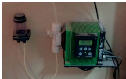
Obr. 4 čerpadlo dávkování stabilizovaného \text{ClO}_2
