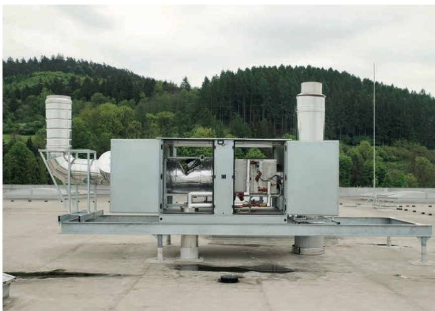
Instalace Heat Recovery Systému ve vnějším prostředí – Slovensko
