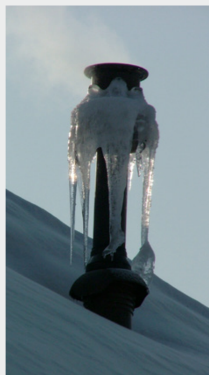
Obr. 2 Kominová stříška na kondenzačním kotli
