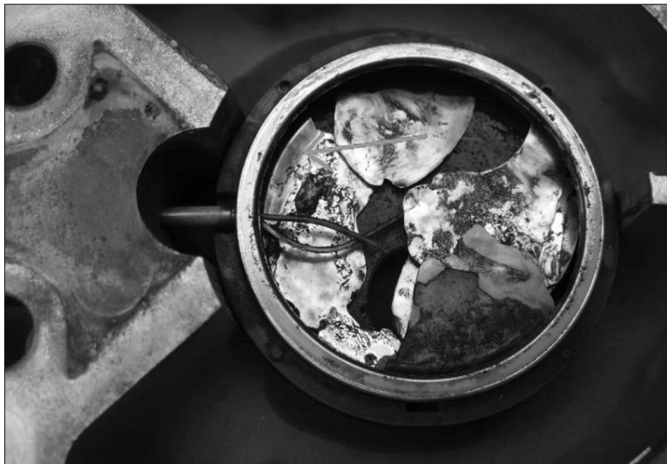
Obr. 2 – Senzor průtokoměru zničený vniknutím páry a působením vysokého tlaku.
