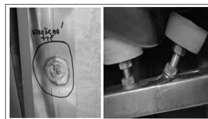
Obr. 6 – Ukázka porušení torzních tyčí (vlevo) a vylomení distančního kolečka (vpravo)
