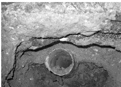
Obr.č.3 Čelní pohled na utavené potrubí plynovodní přípojky v horní části nad potrubím je vidět částečně utavený kabel
