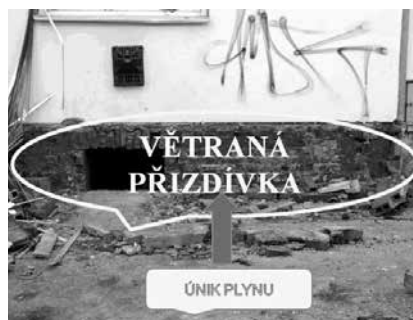
Obr.č.2 Místo s únikem plynu po destrukci větrané přízdívky
