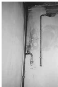
Obr.č. 1 Pohled do plynoměrné místnosti po úniku plynu
