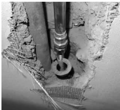
Obr.č.2 Detailní pohled na místo úniku plynu
