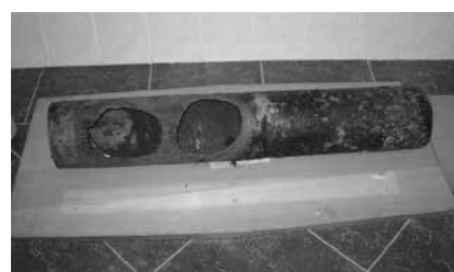
Obr.č.2 Potrubí se 2 vypálenými otvory kabely v důsledku přímého dotyku s potrubím
