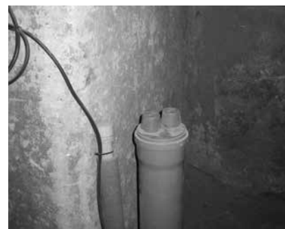
Obrázek 5 - Ukázka poddimenzovaného přívzdušňovacího ventilu na splaškovém odpadním potrubí
