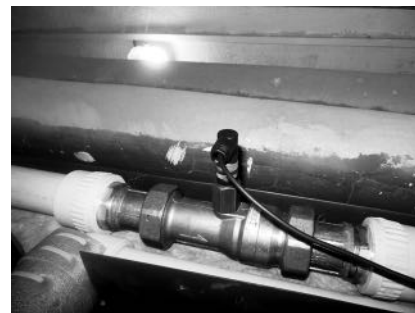
Obrázek 2 – Průtokoměr VT 4025 MSHNS000F osazený na hlavním přívodním potrubí teplé vody bytového domu v Brně
