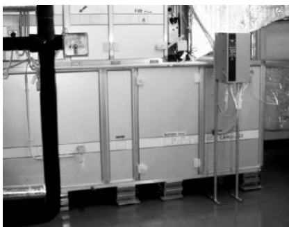
Obr. 5 Ukázka vynesení vzduchotechnické jednotky podepřením jejího rámu cihlami
