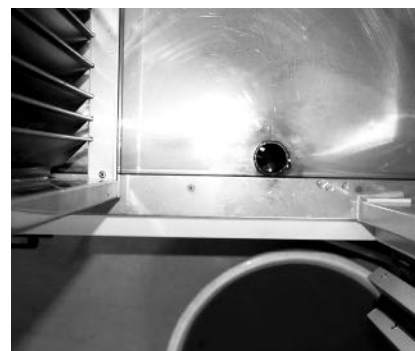
Obr. 2 Boční výtok kondenzátu včetně stojící kapaliny v místě odtoku (tzv. nezapuštěná vana vlevo) a zapuštěný výtok při boční straně vany na kondenzát při pohledu shora (vpravo)
