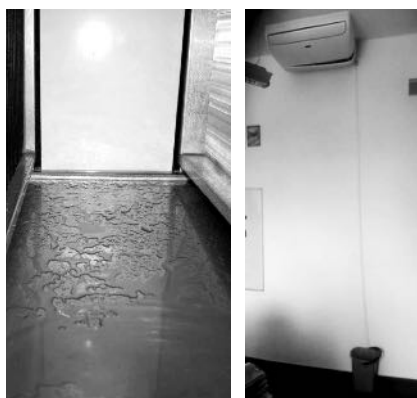
Obr. 1 Ukázka stojící a neodtékající vody z komory chlazení ve vzduchotechnické jednotce (vlevo), nesprávně provedený odvod kondenzátu od výparníku klimatizace (vpravo)
